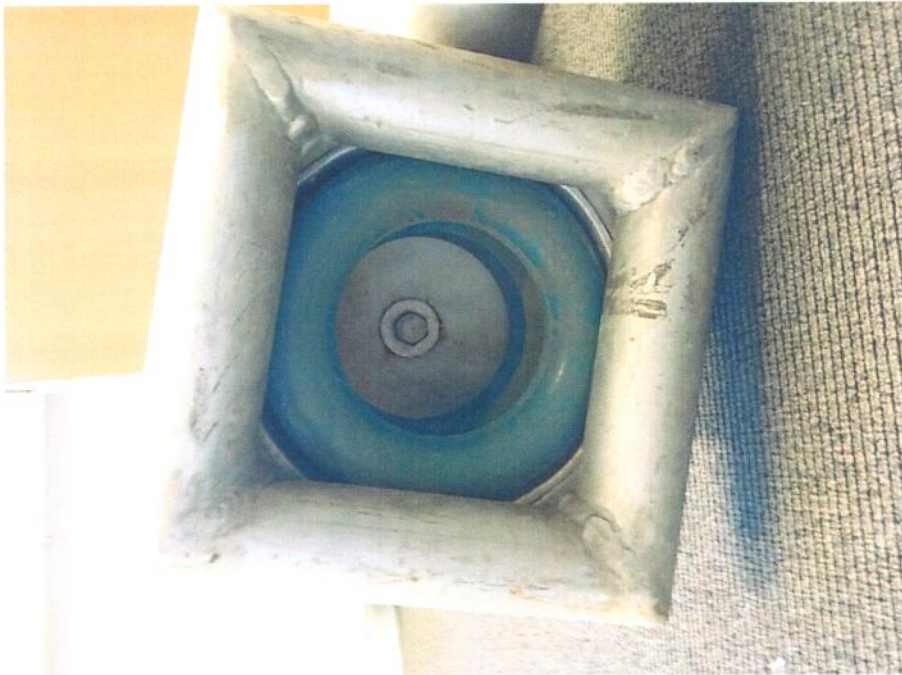
Bilde 2. På hver side av bremsen i gjennomføringen ligger 3 garnringer.
